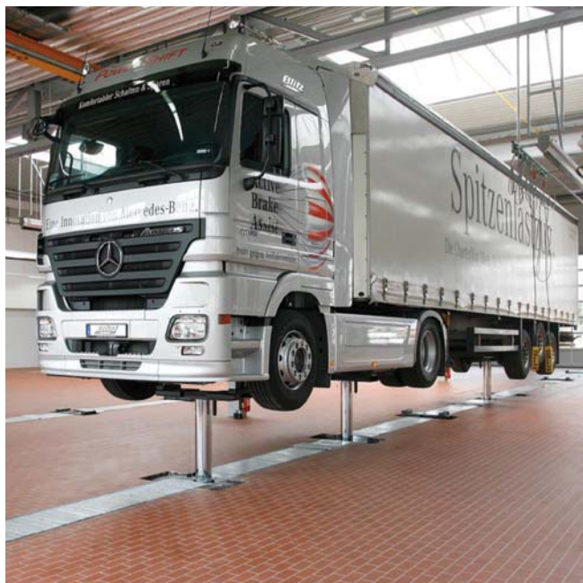
PRZYKRYTY ROLETĄ KANAŁ Z WIELOMA PODNOŚNIKAMI WSPÓŁPRACUJĄCYMI W SYSTEMIE DUPLEX
